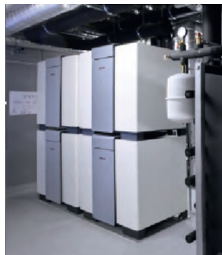
Cascade de 4 PAC géothermiques (250kW), pour le chauffage et la production ECS de 5 immeubles.
