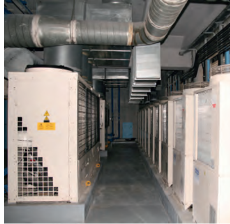
→ L'air froid rejeté par les DRV est évacué à l'extérieur du bâtiment.
