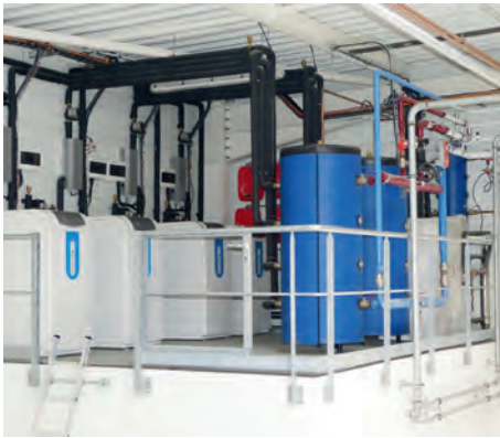
→ Les pompes à chaleur, dont la régulation est de type tout ou rien, fonctionnent en cascade. Elles produisent une eau dont la température est comprise entre 43 et 47 °C.
