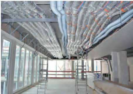
→ Les 180 micro-ventilateurs (MT21) alimentent par des gaines rondes unitaires les 180 poutres froides monodirectionnelles disposées le long des façades.
