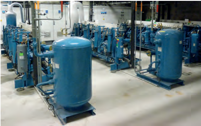
→ L'installation comporte 4 centrales frigorifiques dotées de compresseurs Bitzer, dont 2 pour le froid négatif et deux pour le froid positif.
