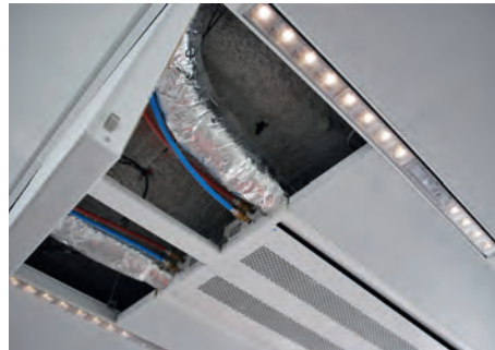
→ Les unités terminales de type poutres froides permettent un recloisonnement ultérieur des espaces intérieurs. Elles sont utilisées comme inducteurs à débit variable, ce qui permet de brasser l'air ambiant.
