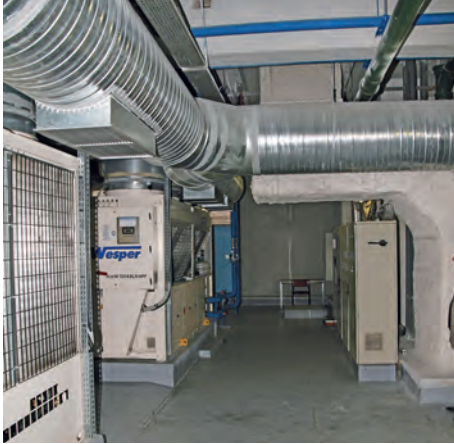
→ Des gaines de ventilation introduisent l'air extrait des locaux juste au niveau des évaporateurs (en mode chaud), des Pac air/eau.
