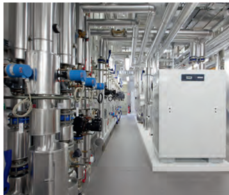
→ La chaufferie du centre de formation, aux allures de laboratoire, fait partie du parcours de visite des stagiaires. Elle abrite une pompe à chaleur eau glycolée/eau de 73 kW.
