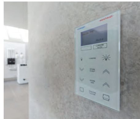
→ La GTB Neuberger pilote l'ensemble du bâtiment, aussi bien en termes de chauffage, de rafraîchissement, de ventilation en liaison avec une station météo présente sur le site, que d'éclairage, de sécurité et protection incendie des locaux.
