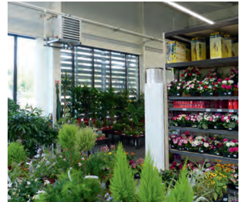
→ Le chauffage s'effectue de façon classique par des aérothermes sur boucle d'eau, afin de garantir une bonne diffusion de la chaleur dans les espaces et réagir rapidement aux consignes de température.
