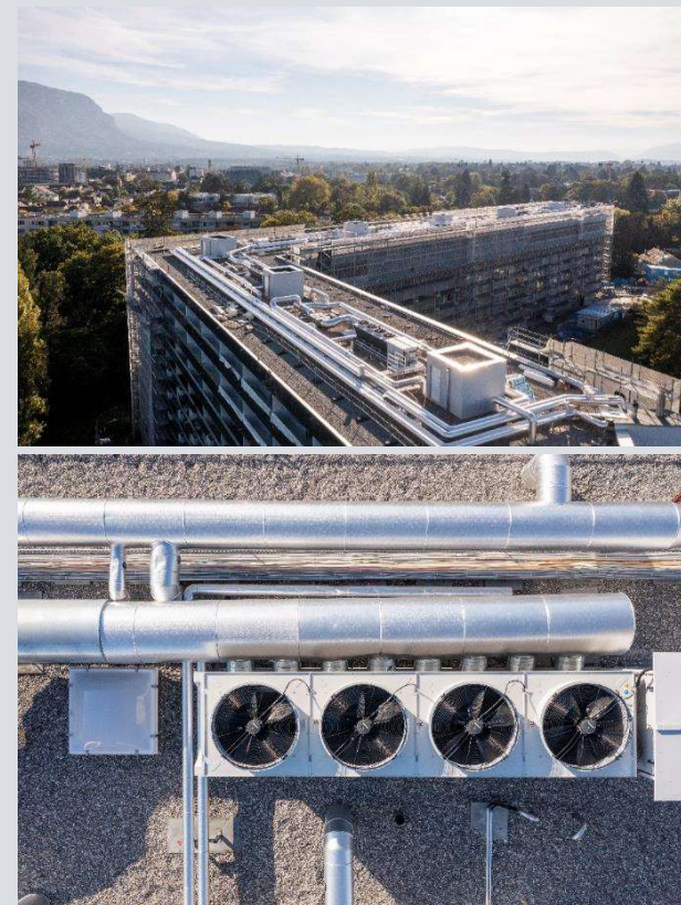
Installations PAC – Chemin de la Montagne
