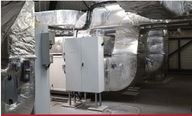
Les centrales de traitement d'air constituent un équipement souvent présent dans les bâtiments tertiaires (source : COSTIC)
