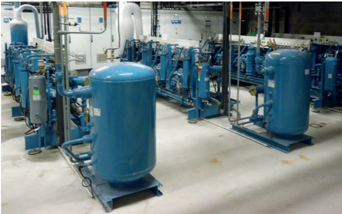
→ L'installation comporte 4 centrales frigorifiques dotées de compresseurs Bitzer, dont 2 pour le froid négatif et deux pour le froid positif.
