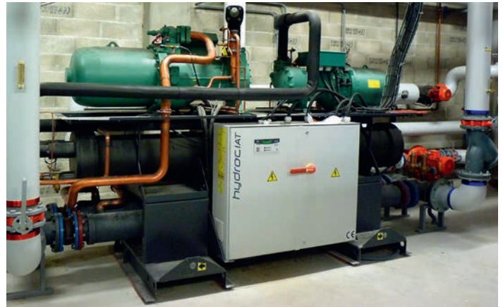
→ La pompe à chaleur eau/eau Hydrociat permet de récupérer les calories sur la production de froid et d'assurer le chauffage de la surface de vente
