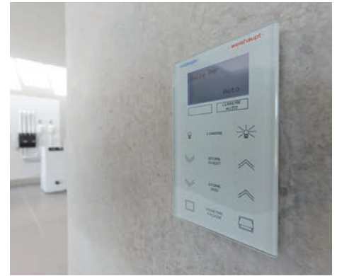
→ La GTB Neuberger pilote l'ensemble du bâtiment, aussi bien en termes de chauffage, de rafraîchissement, de ventilation en liaison avec une station météo présente sur le site, que d'éclairage, de sécurité et protection incendie des locaux.
