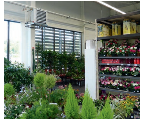
→ Le chauffage s'effectue de façon classique par des aérothermes sur boucle d'eau , afin de garantir une bonne diffusion de la chaleur dans les espaces et réagir rapidement aux consignes de température.
