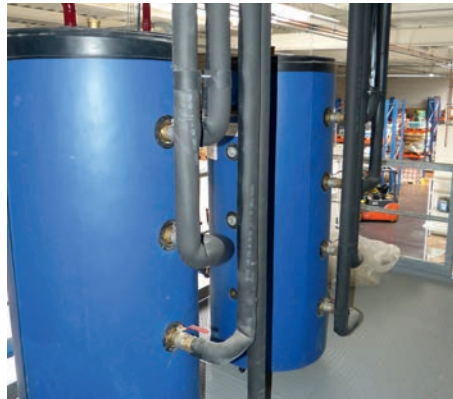
→ Les pompes à chaleur sont raccordées à deux ballons-tampons d'une contenance unitaire de 500 litres, avant d'alimenter le réseau des aérothermes via deux pompes de circulation à débit variable.
