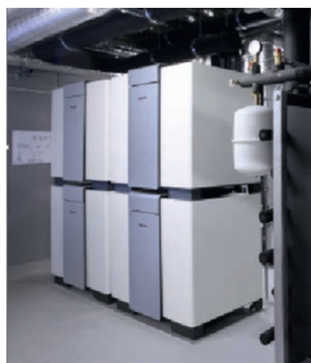
Cascade de 4 PAC géothermiques (250kW), pour le chauffage et la production ECS de 5 immeubles.
