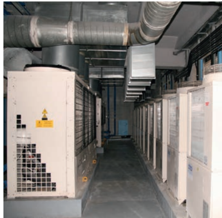
→ L'air froid rejeté par les DRV est évacué à l'extérieur du bâtiment.
