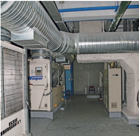
→ Des gaines de ventilation introduisent l'air extrait des locaux juste au niveau des évaporateurs (en mode chaud), des Pac air/eau.
